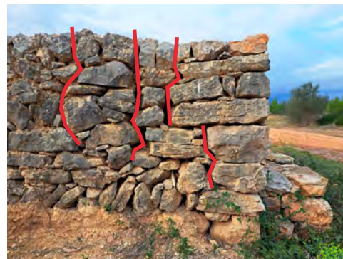
Paret lateral d'una barraca amb debilitat estructural causada per diverses cremalleres (assenyalades a la imatge inferior) que han provocat un abombament de la paret posterior, que s'ha reforçat amb la construcció d'un contrafort.
