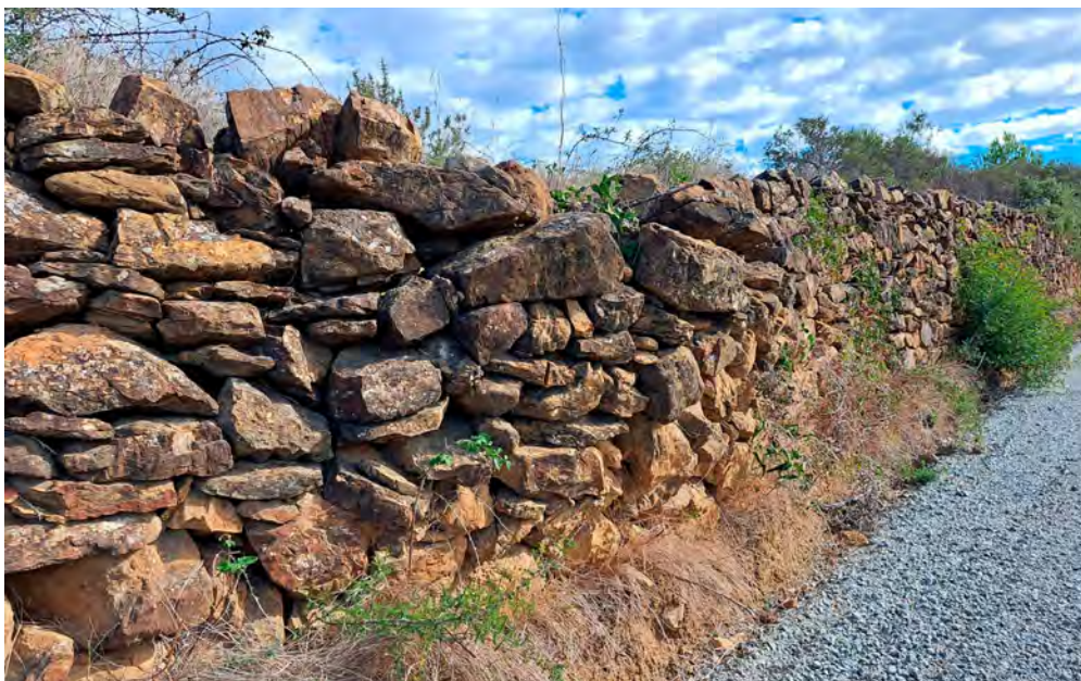
Abombament d'una paret de feixa a Pont de Molins. La pressió que acumula la paret i una debilitat constructiva han provocat una important deformació, que cedirà a curt termini.
