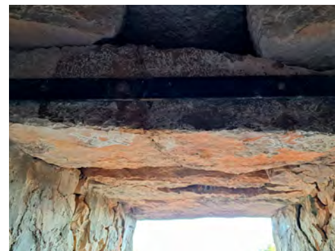
Corredor amb una llosa partida, i reparació preventiva amb material segellador i un tirant metàl·lic.
