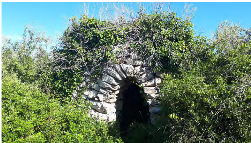
Els elements vegetals sovint colonitzen les construccions de pedra seca i afecten també la seva solidesa.
